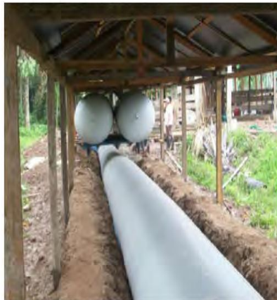
Biodigester tubular de 20 m con 2 reservorios de biogás de 1.7 m 3 cada uno, produce 1 250 litros de Biol por día.
